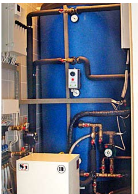
Värmesystemet styrs från teknikrummet.
